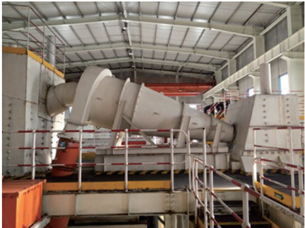
图 1 煤制油选煤厂重介旋流器现场
